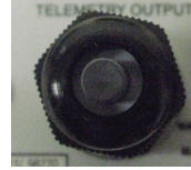
Cable Gland no cable
