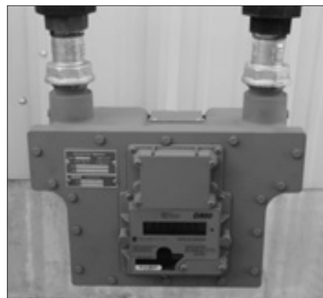
Figure 7.4 - Compteur placé en ligne
