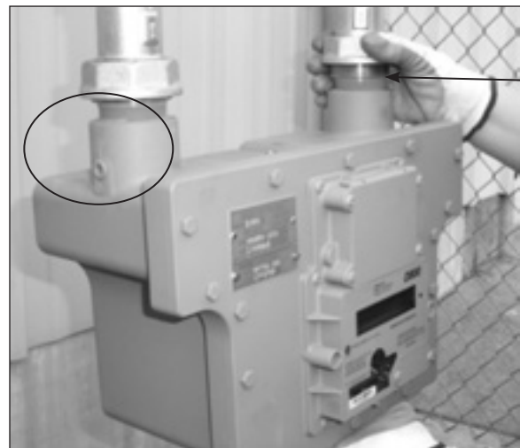
Figure 11.1 - Les prises sous pression différentielle sont situées sur les connecteurs d'entrée et de sortie.
