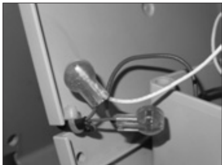
Figure 7.21 - Câble ERT correctement acheminé dans la plaque arrière
