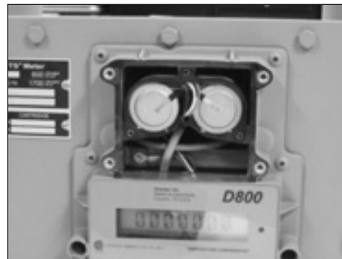
Figure 9.31 - Batterie en place
