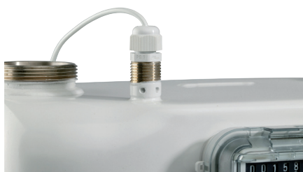
Termopoco instalado no ACD padrão
